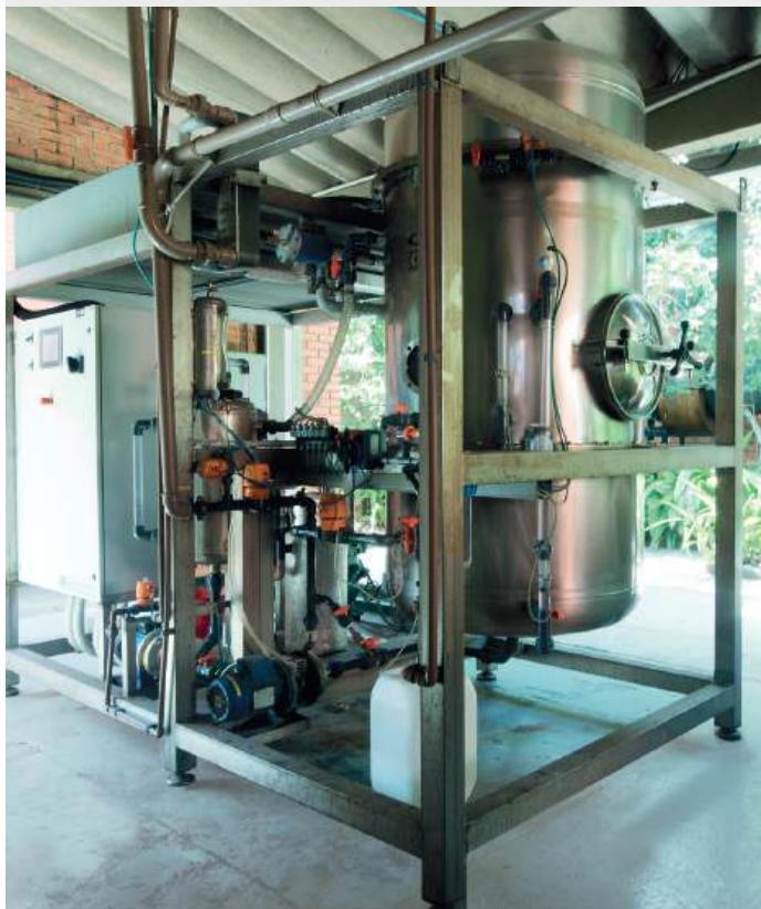
Evaporador a vácuo para eliminação dos contaminantes químicos e desmineralização de efluente.
