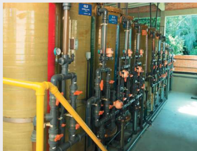
Estação de tratamento das águas de lavagem da galvanoplastia em circuito fechado com processo de resina de troca iônica.
